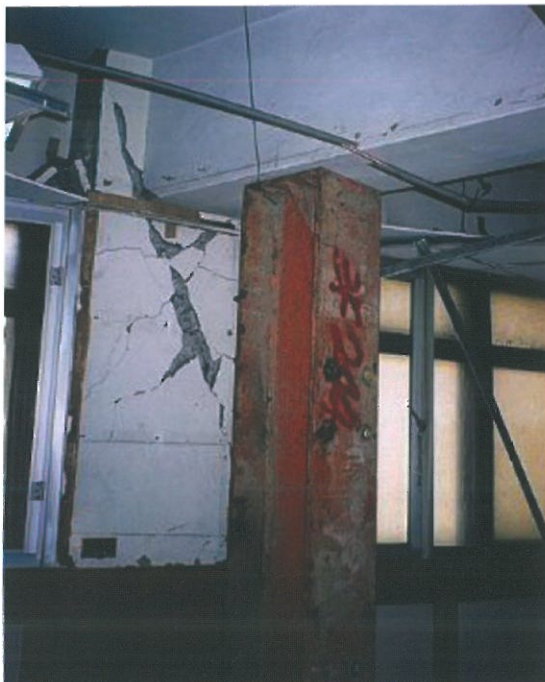
(九) 樑柱接合處破壞 ，樑端45度裂縫
