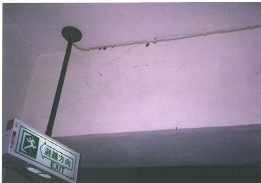
(十) 樑端45度斜裂縫
